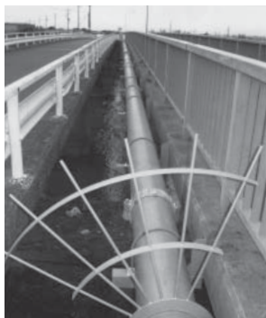
■SGめっき水管橋
