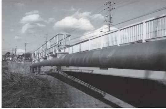
■SGめっき水管橋
